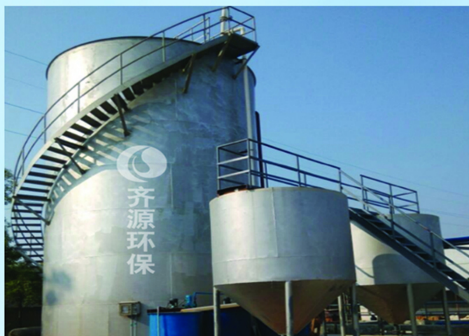
江西东方巨龙化工有限公司污水处理工程
