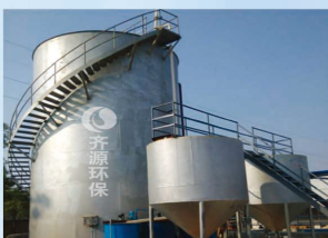
江西东方巨龙化工有限公司污水处理工程
