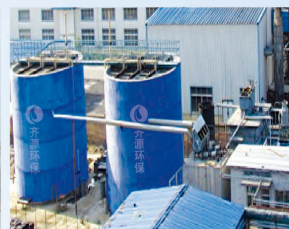
山东华阳油业污水处理工程
