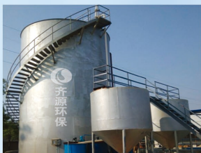
江西东方巨龙化工有限公司污水处理工程
